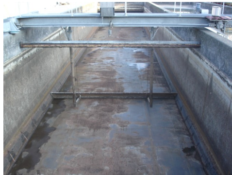
Hier sehen wir das Vorklärbecken mit einem großen Rechen
